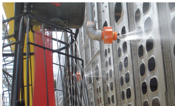
Système combinant la nébulisation et la ventilation. Source : Centre de recherche et de développement de Sherbrooke, AAC
