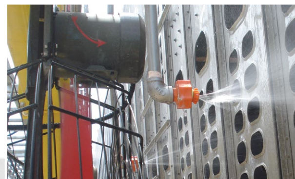
Système combinant l'aspersion et la ventilation. Source : Centre de recherche et de développement de Sherbrooke, AAC
